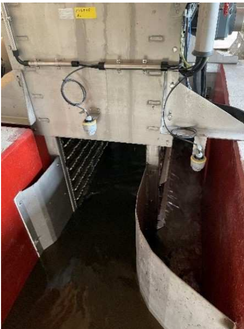
Leitbleche im Zulaufbereich
